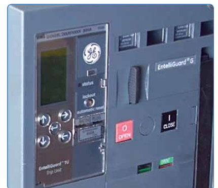
Les dispositifs de déclenchement et tous les indicateurs sont visibles à travers la porte
