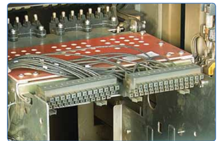
Accessibilité au câblage secondaire
